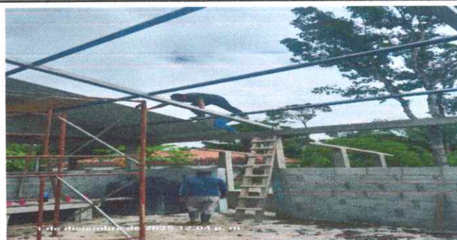
Foto 4: Se observa la pared de la cocina.
